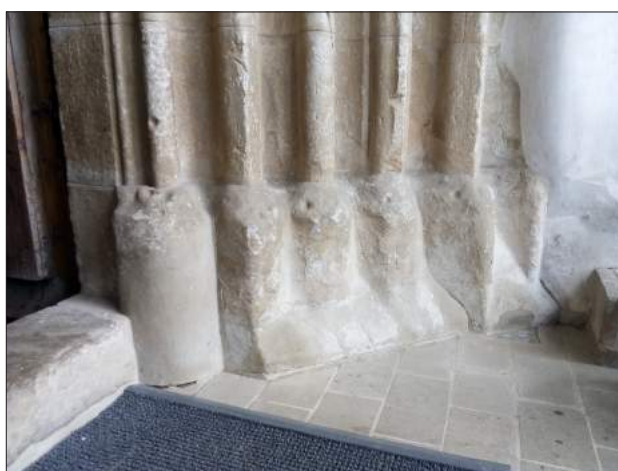
Fot. 22. Ślady na portalu głównym – Sighișoara.
