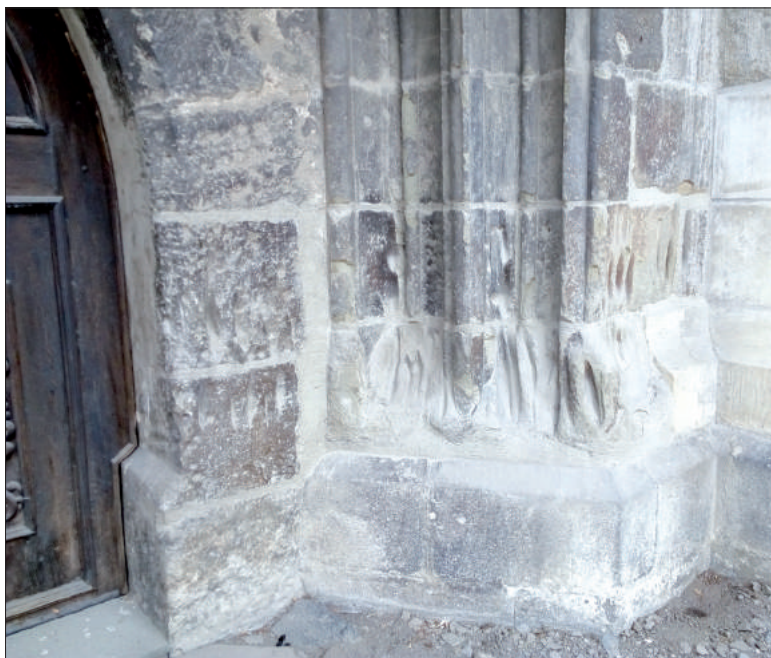
Fot. 17. Bruzdy na jednym z portali południowych w Braszowie.
